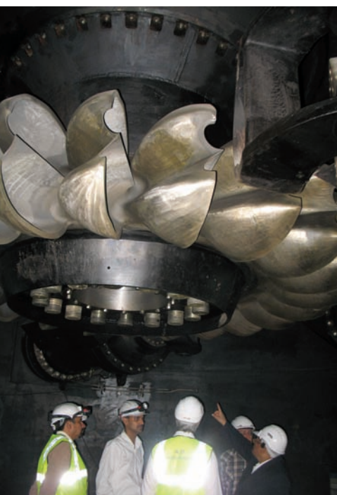
Turbina, proyecto hidroeléctrico Allain Duhangan , India
