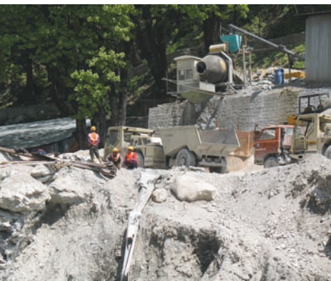
Visita del equipo de CAO Cumplimiento a la central hidroeléctrica de Allain Duhangan , India
